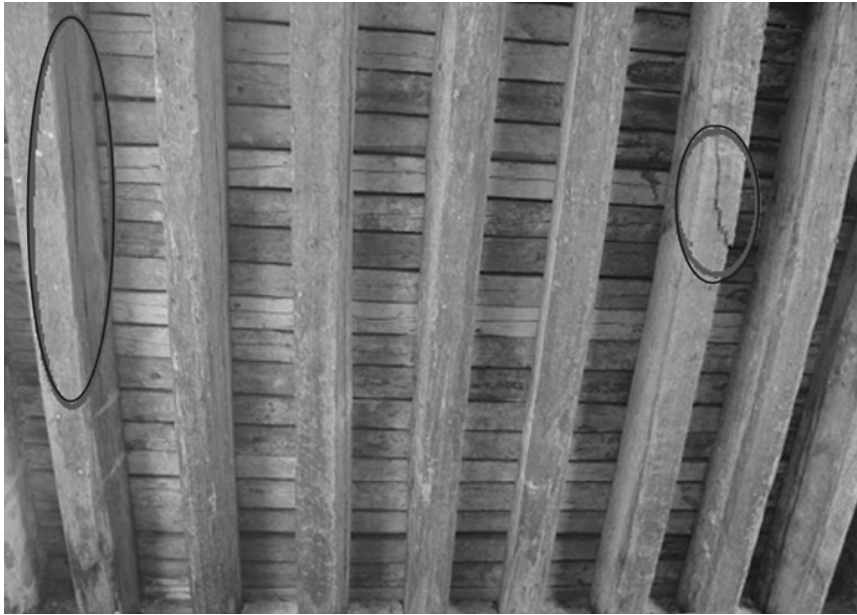
IMAGEN 2. Parte inferior de la calzada del puente El Sabino en donde se observa el sistema de vigas, así como algunas fracturas marcadas en el círculo. Fotografía de Mauricio A. Lovera Limberg.
