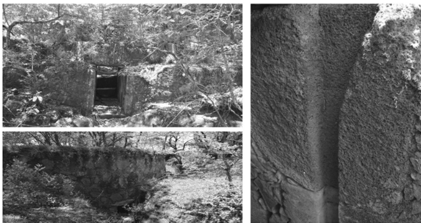
IMÁGENES 10a, 10b y 10c. Arriba: cortina de la presa I. Abajo: vista interior de la cortina. Derecha: detalle de la acanaladura en piedra de basalto de la compuerta.
