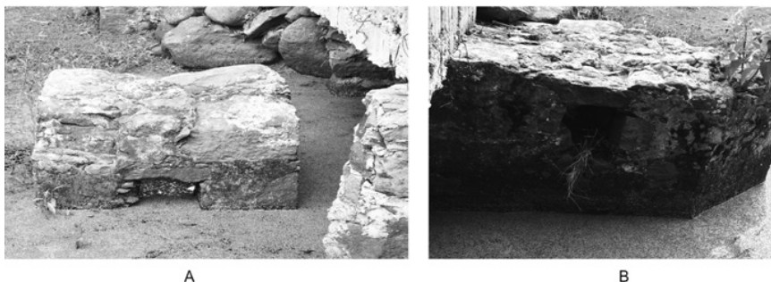
IMAGEN 13 Puente menor en el camino de la estancia de Mexicaltongo hacia San Lorenzo Texcaltitlán formado por tajamares. A) Se observa un orificio en el tajamar en donde iban las vigas de madera. B) Acondicionamiento del puente por uno de concreto. Fotografías de Mauricio A. Lovera Limberg. 27
