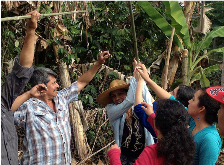
Construcción de temazcal en la casa Cecomu. Chiltoyac, Ver. 14 de diciembre de 2016. (Foto: Cristina Núñez)
