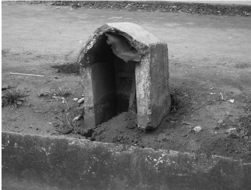
Foto 1. Lápida urbana localizada en la prolongación de la Avenida Mártires 28 de Agosto, en la ciudad de Xalapa, Ver.
